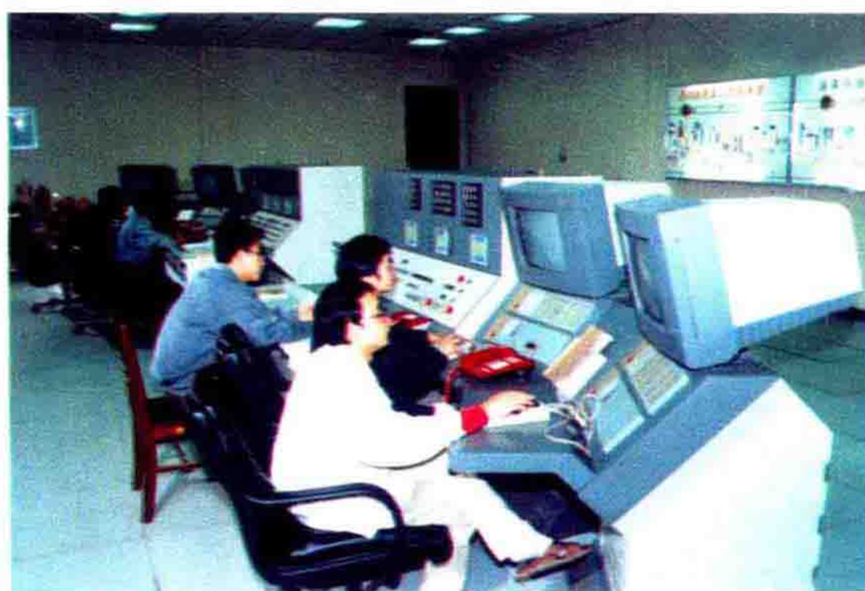
建峰化工总厂现代化的生产车间 (建峰总厂提供)
