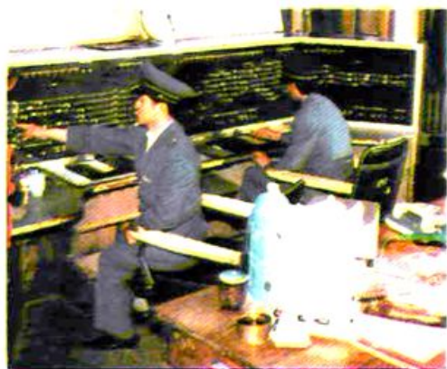
7 · 无线电列调室
