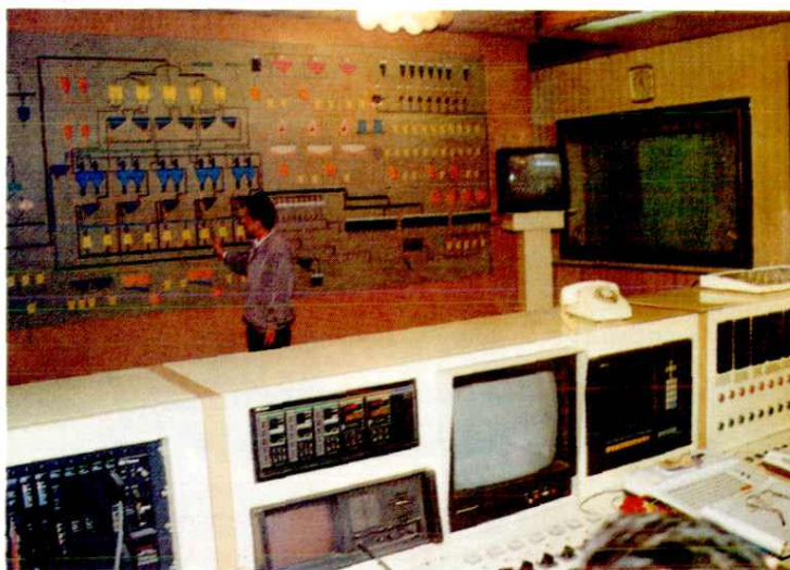
株洲洗煤厂洗煤车间的集中控制室
