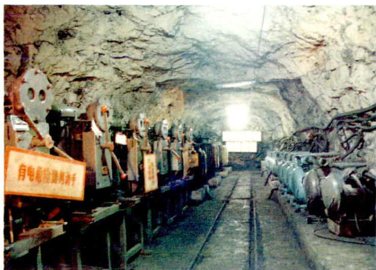
煤炭坝煤矿的采区变电所
