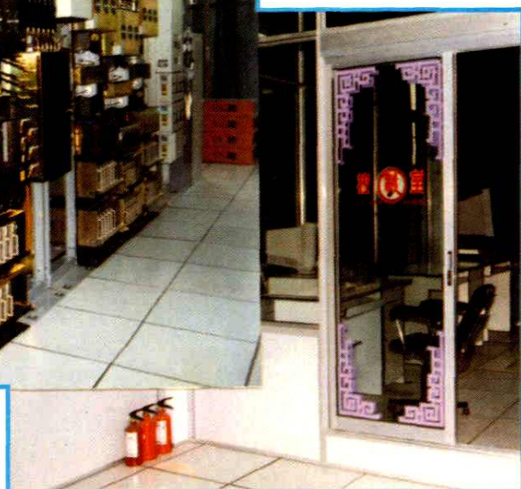
璜泾邮电局电讯 机房的移动电话 基站装置及程控 电话控制室
