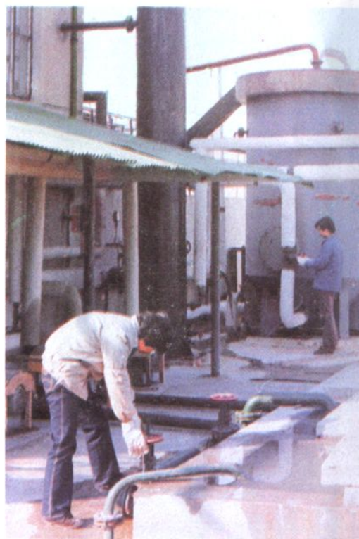
▶上海长江化工厂废水处理设施
