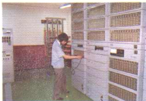
公司有线总机房
