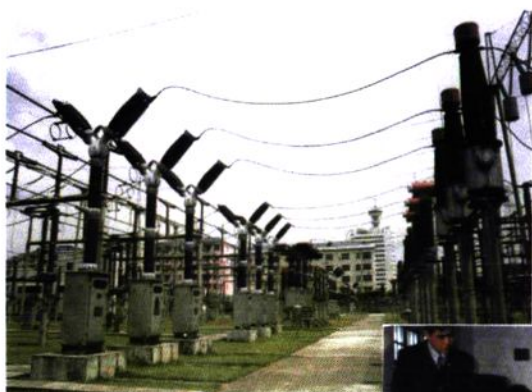
图为220kv的集里变电站设备区。
