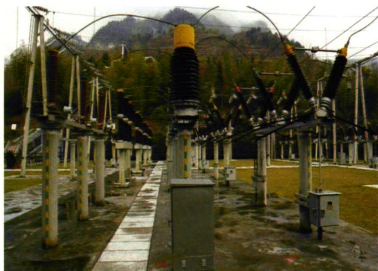
综合自动化改造后的升压站
