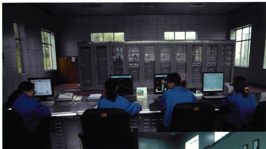
综合自动化改造后的监控室
