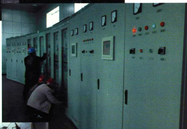
综合自动化改造后的发电机保护屏
