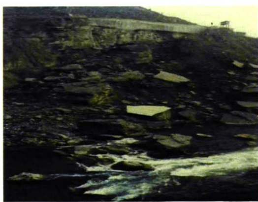
坍塌的天电老前池
