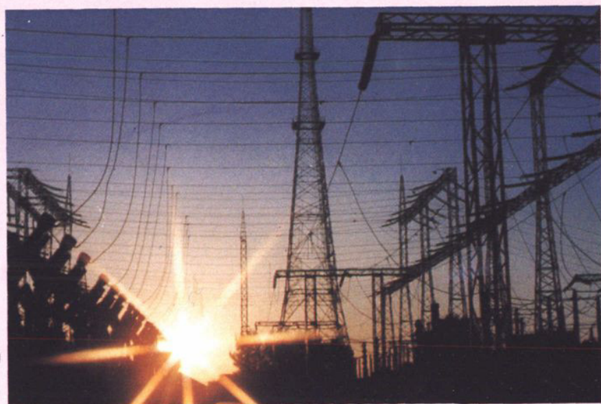
锦西一次变电所开关场
