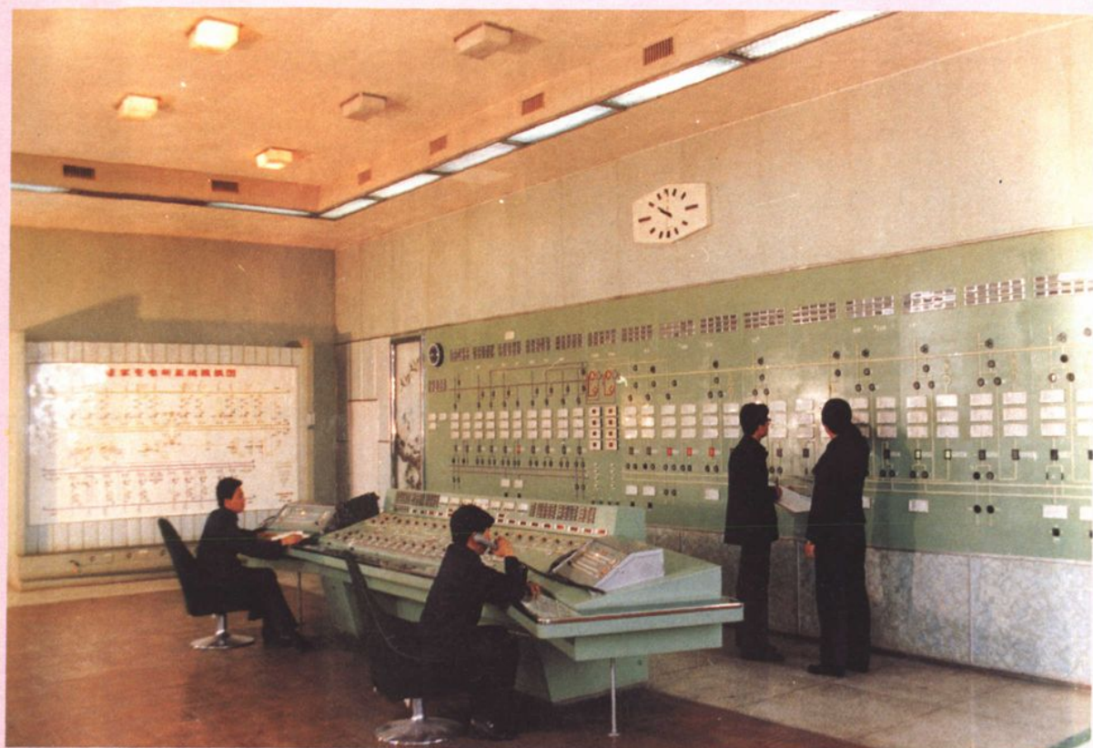
董家变电所主控室
