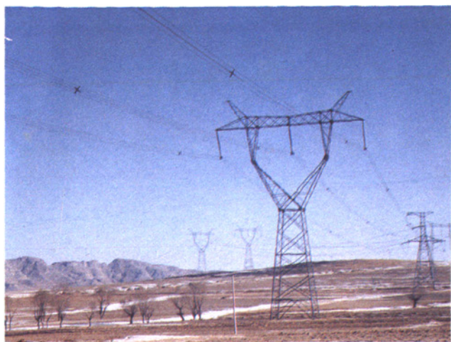
▲ 500 千伏送电线路
