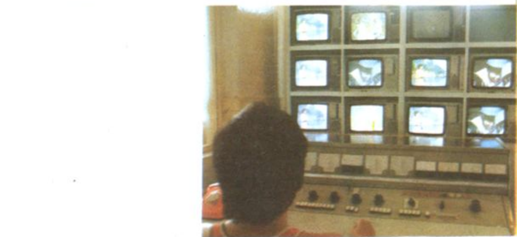
烟台电视台 发射机房控制室 （下）
