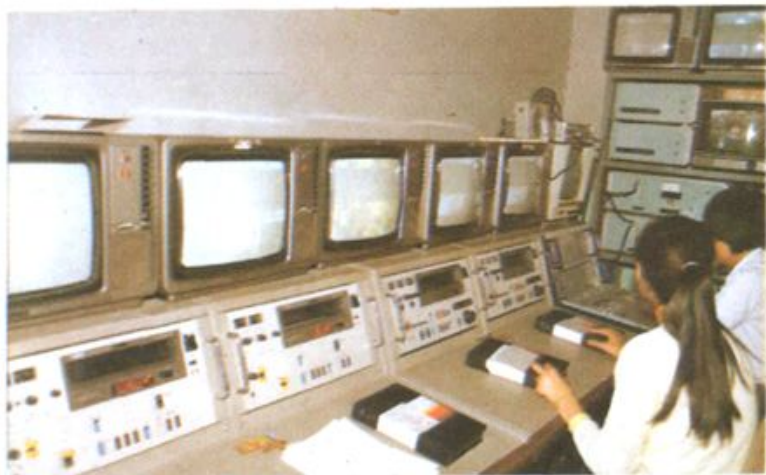
烟台电视台 播出机房（中）
