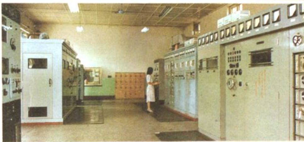
烟台人民广播电台发射总控制室 （上）
