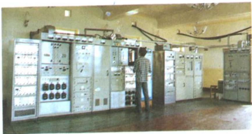
烟台电 视台发射机 房
