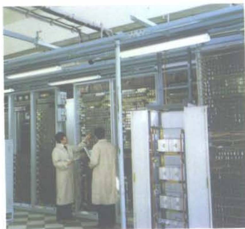
程控交换机房
