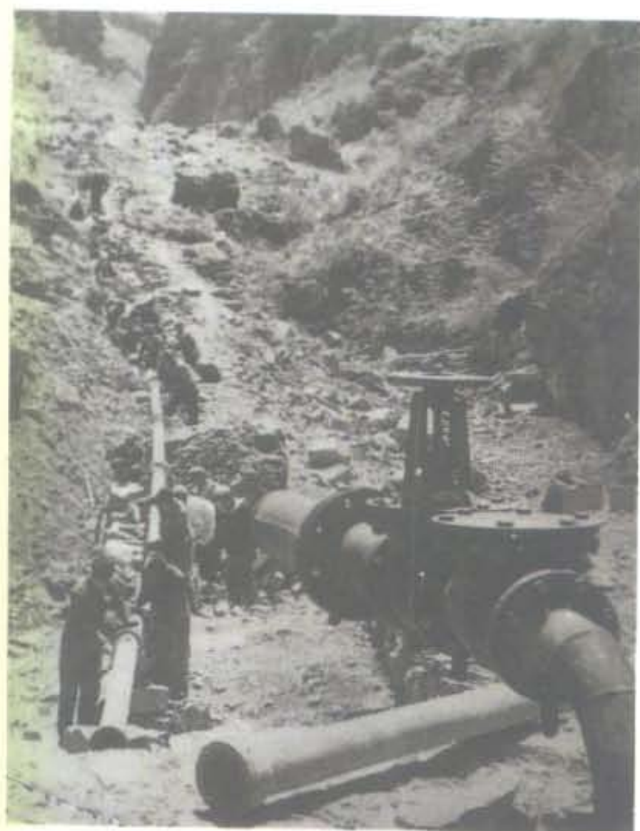
乱石泉送水工程
