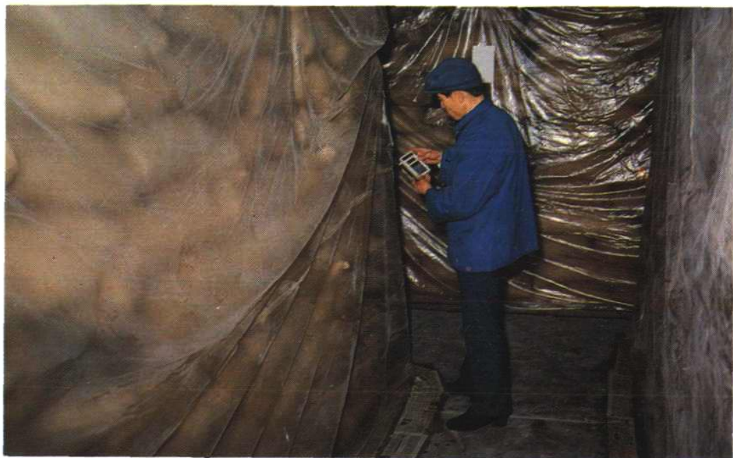
▼ 定海区中心粮库电子监测粮情
