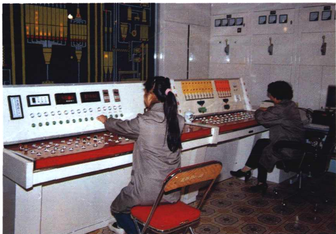
▲ 定海饲料厂电脑控制室
