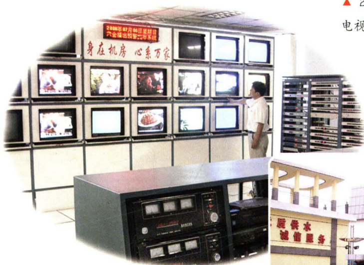
▲ 县电视台机房
