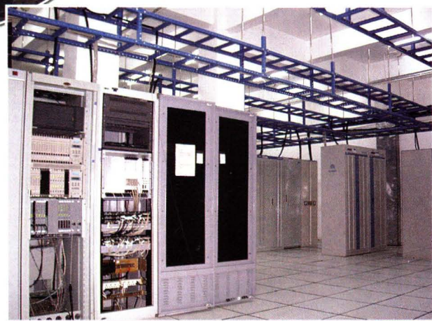
▶ 电信通信机房
