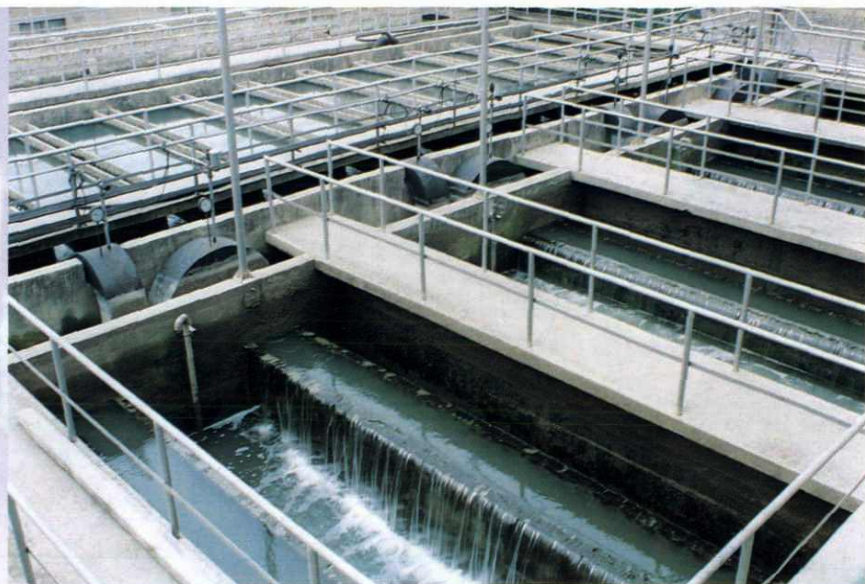
给水分厂日处理水5万吨的净化站
