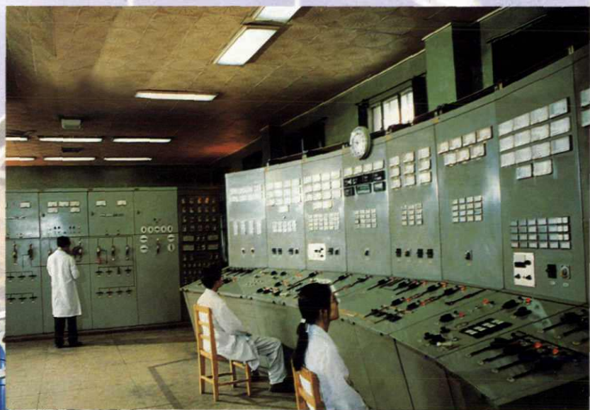
热电分厂主控室
