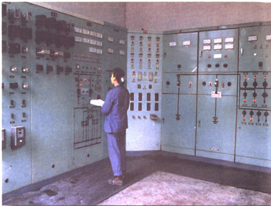
12500KVA 石墨化电炉变压器配电室
