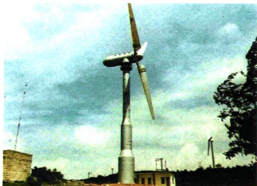
公司安装的平潭风力发电站
