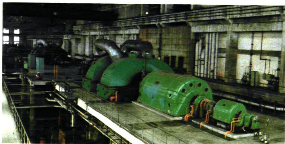
公司安装的漳平电厂 1、2 号 10 万千瓦机组
