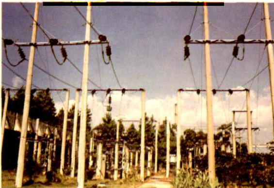
乐昌市枇杷岭变电站
