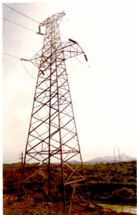
昌山变电站 110KV 出线铁塔
