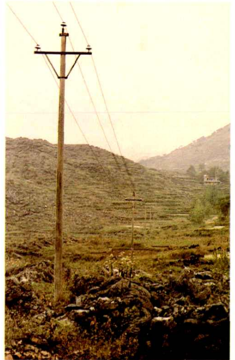
乐昌沙坪（石灰岩山区）输电线路
