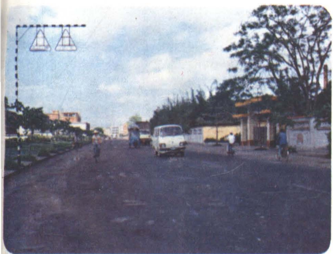
广湛公路114公里处路况
