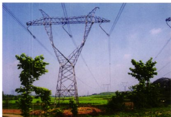
500千伏凤凰山—下王太输电线路工程是阳逻电厂二期外送重点工程，于1997年12月动工，1999年2月竣工
