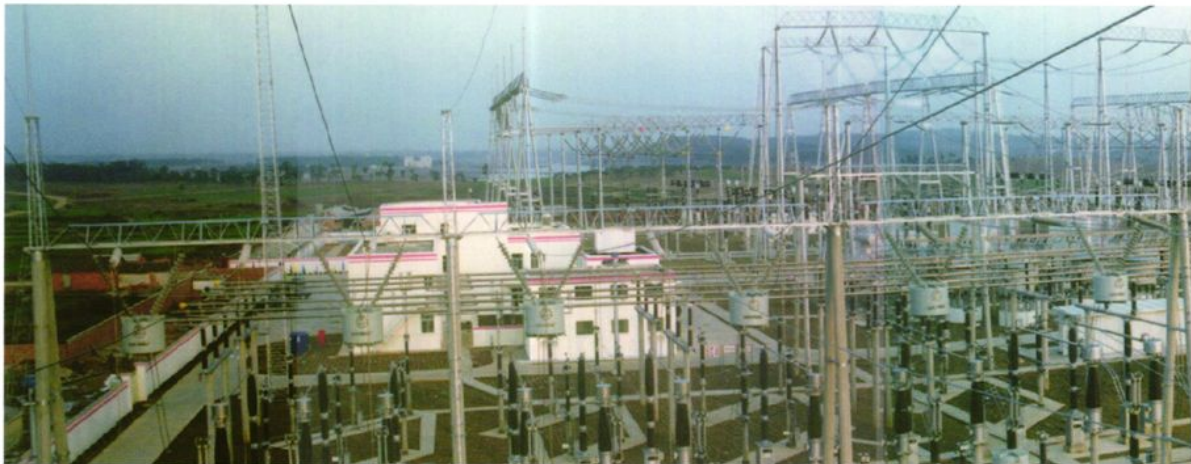
500千伏孝感变电站是三峡电力外送配套工程，于2000年6月动工，2002年底全站设备一 次投运成功。图为变电站全景
