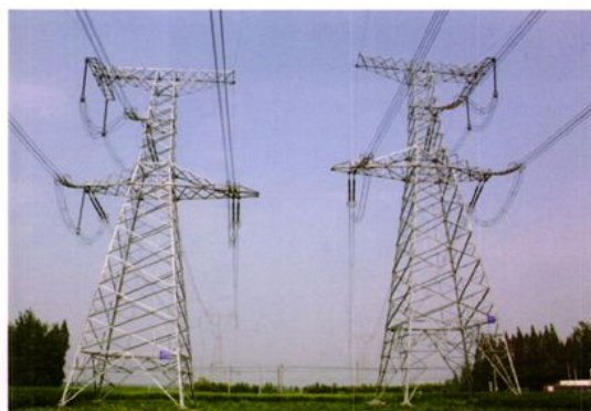
500千伏孝感变电站—汉阳变电站输电线路工程是鄂东500千伏环网的重要组成部分，是湖北“西电东送”通道的主要联络线，于2000年11月动工，2001年11月竣工
