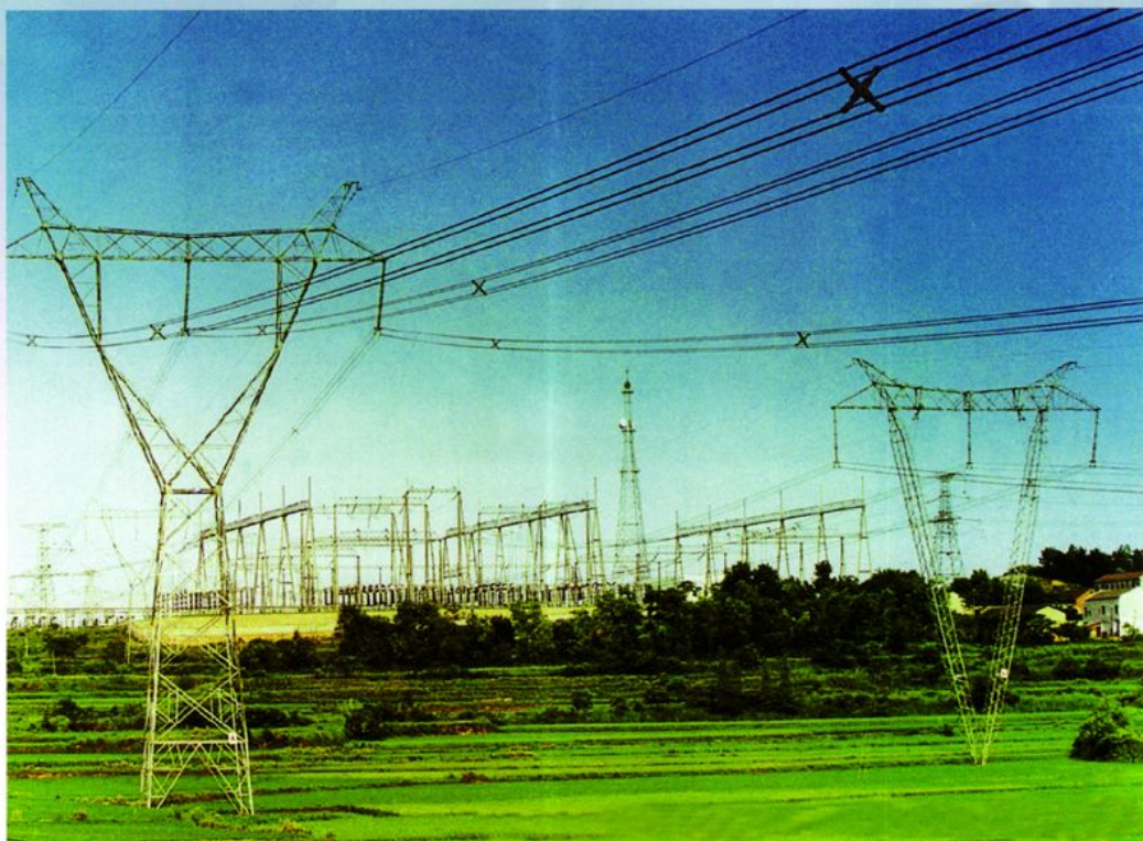
500千伏汉阳变电站是湖北电网枢纽变电站，于1994年6月动工，1996年3月并网运行。图为变电站出线
