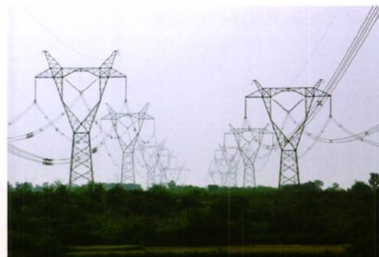
500千伏汉阳变电站—孝感变电站Ⅱ回输电线路
