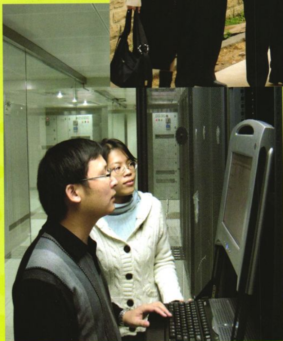
◀ 2007年3月18日，局数据中心机房竣工并投入使用
