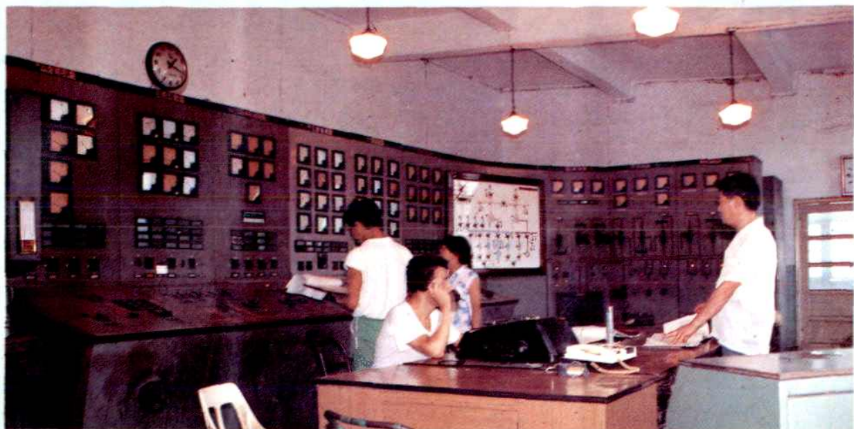
電氣主控制室
