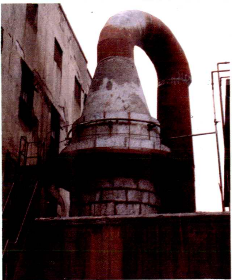
為減輕城市污染安裝的 鍋爐立式水膜式除塵器
