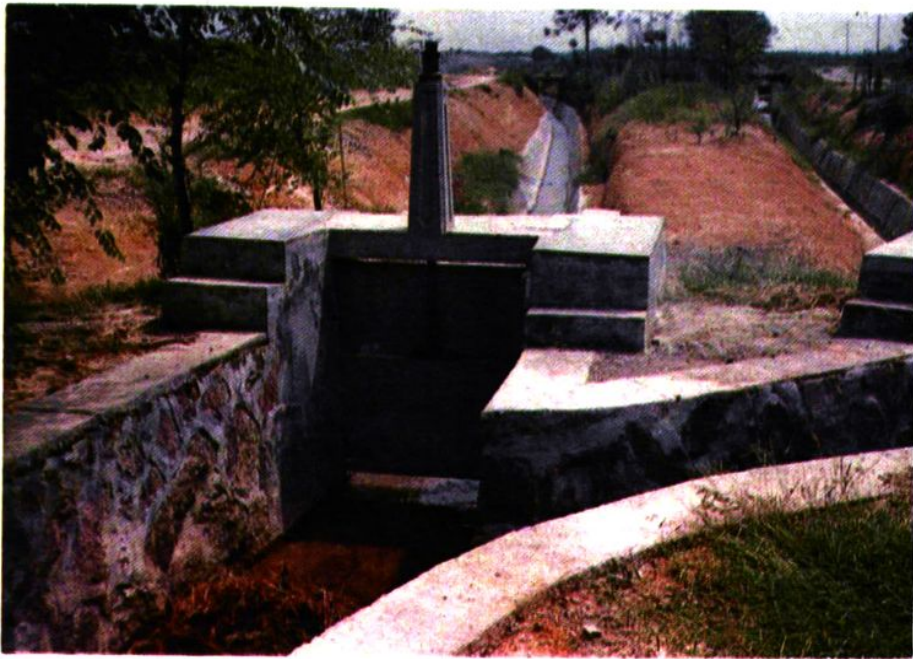
十七、由巧溪水库和佛堂机电排灌站生产的封闭式启闭机。
