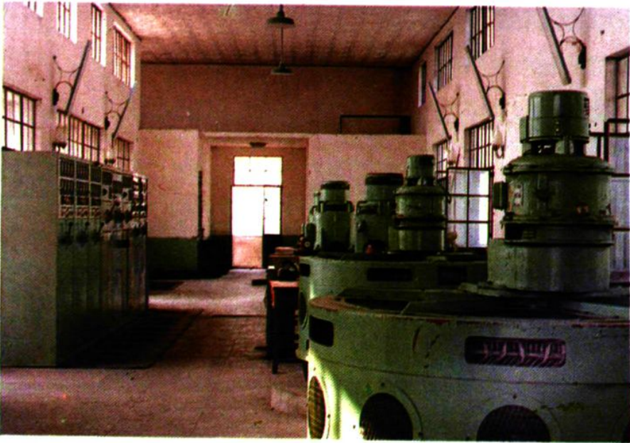
九、杨宅水轮泵站左岸电站内景。
