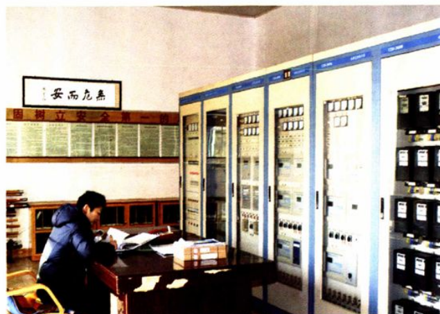
变电运行值班
