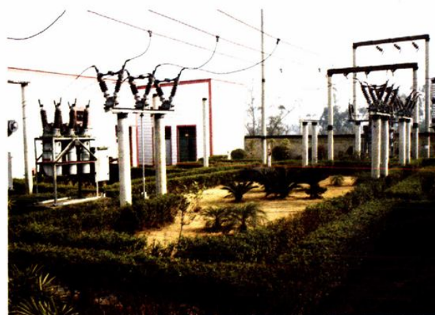
公司35千伏丰禾变电站
