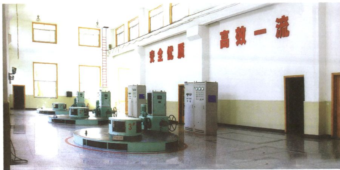
赋石水库电站厂房内景
