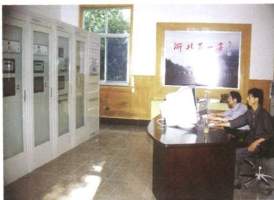
赋石水库电站中控室
