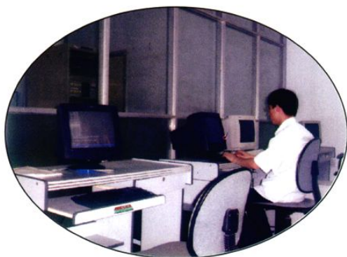
▲ 遂宁市邮政局邮储绿卡网机房
