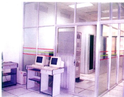
▲ 遂宁市邮政局综合计算机网机房
