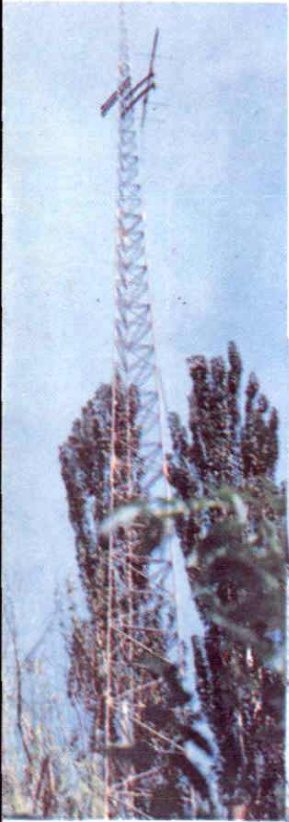
管理处无线电话 接收塔
