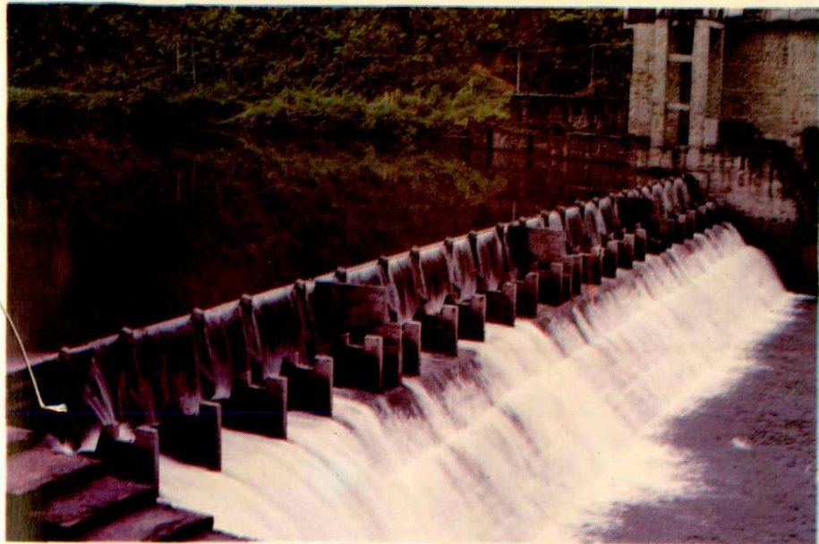
万源县罗文乡沙坝电站 水力自动控制翻板闸
