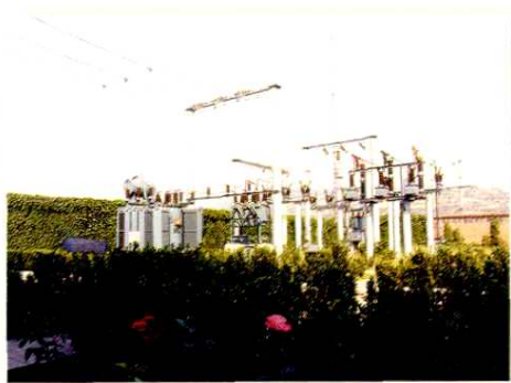
两渡 35 千伏变电站
