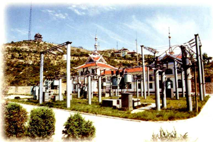
翠峰山500千伏变电站
