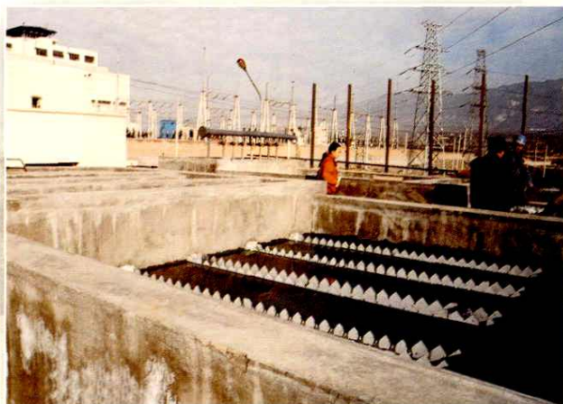
山西天石电力有限公司污水处理站
