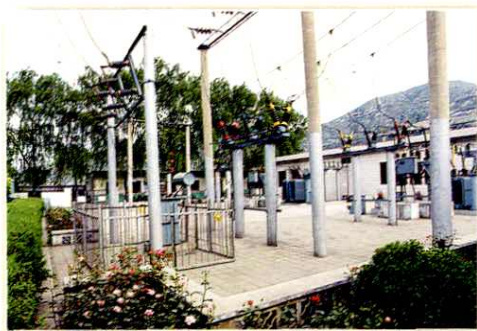
厦门 35 千伏变电站
