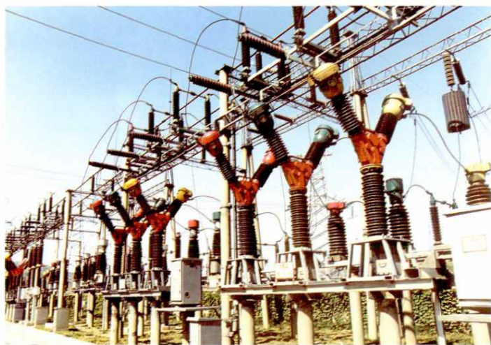
灵石 110 千伏变电站
