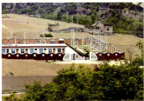
交口 35 千伏变电站
