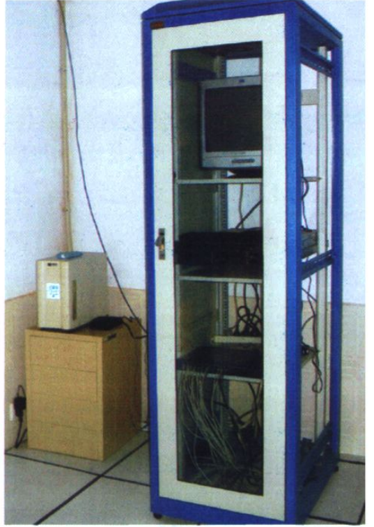
二〇〇五年建成的信息华局域网机房一角
