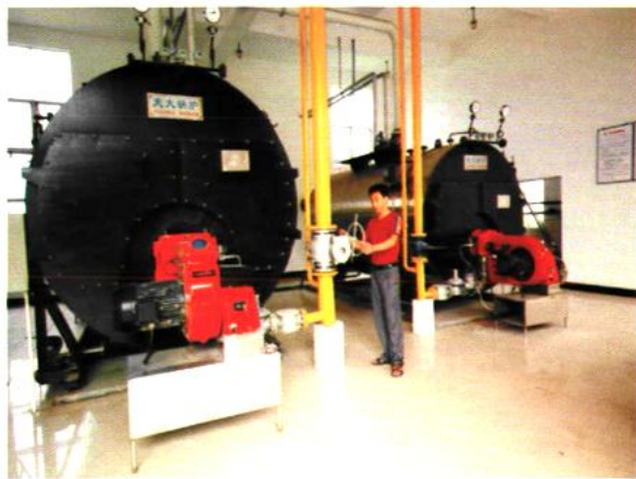
天然气锅炉房
