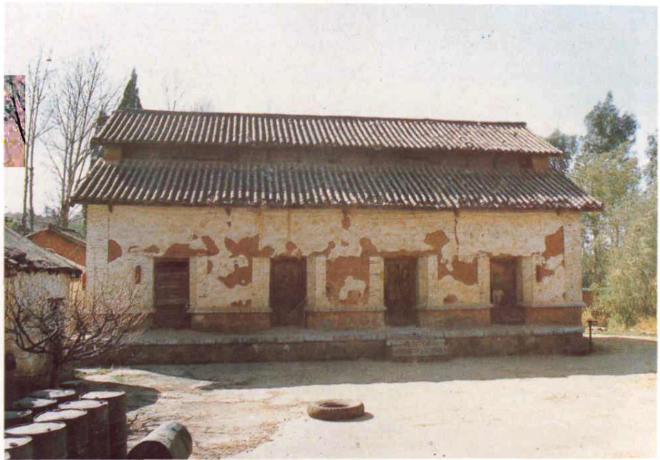
接管仓（官渡区大石坝）。
