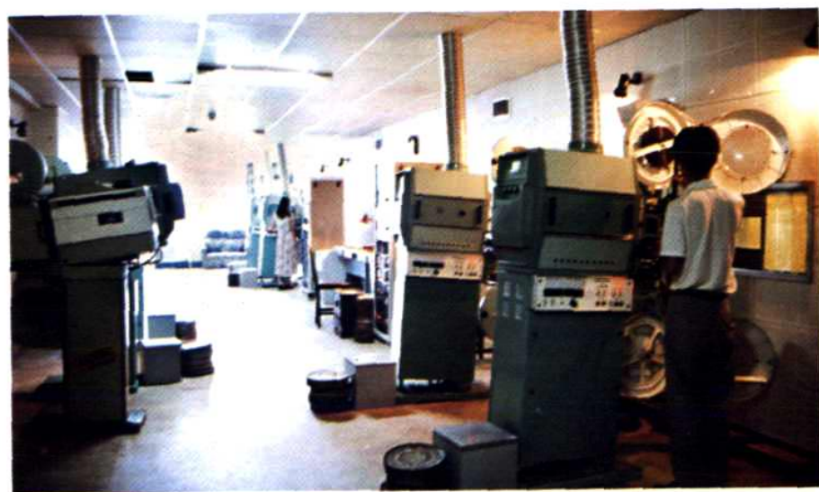
浙北影城多厅 电影放映机房 (姚有云摄)
