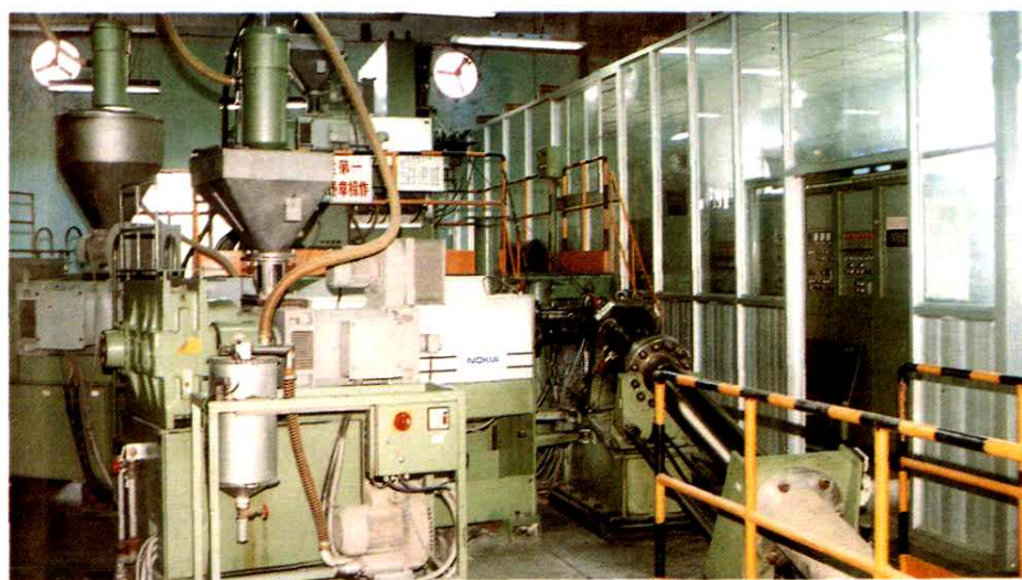
兰溪电缆厂交联 工段一角
