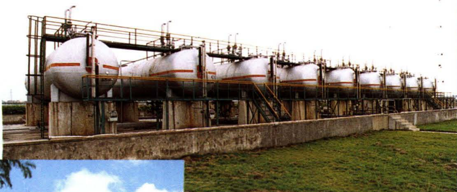
△ 青浦液化气储存站
