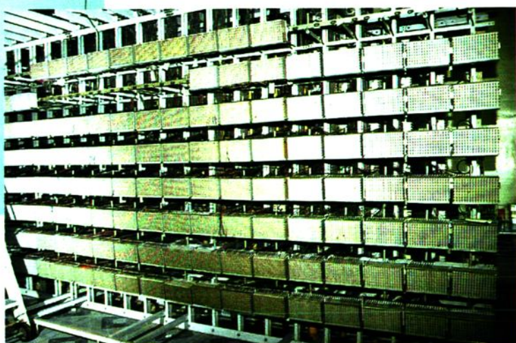
程控交换机配线架
