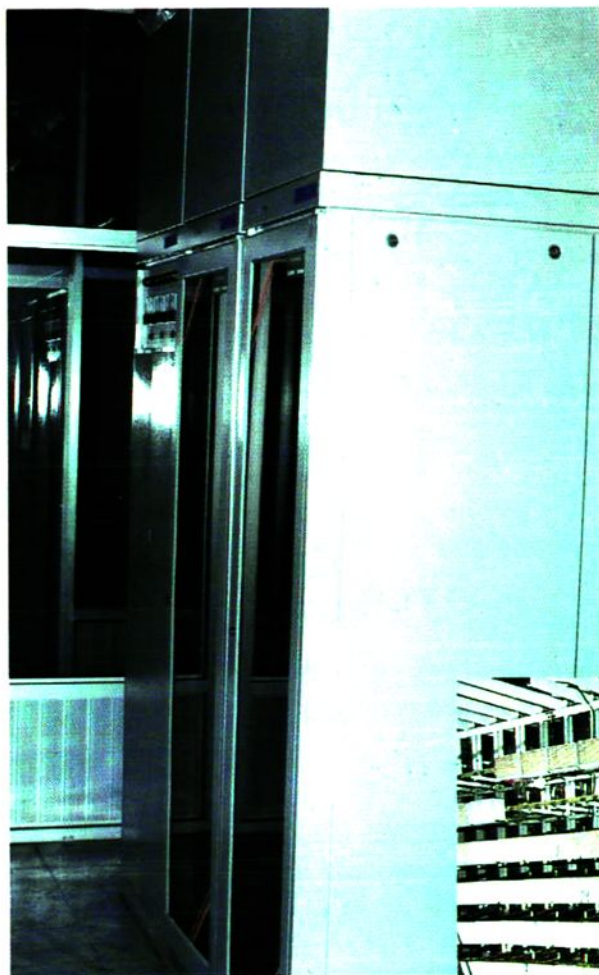
数据通信设备
