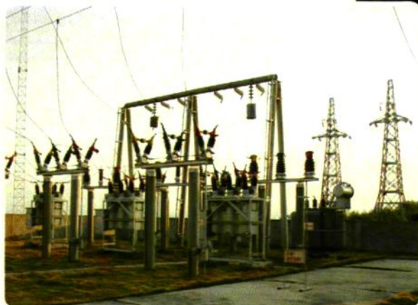
宜昌市黄柏河流域棠垭调度中心变电站
