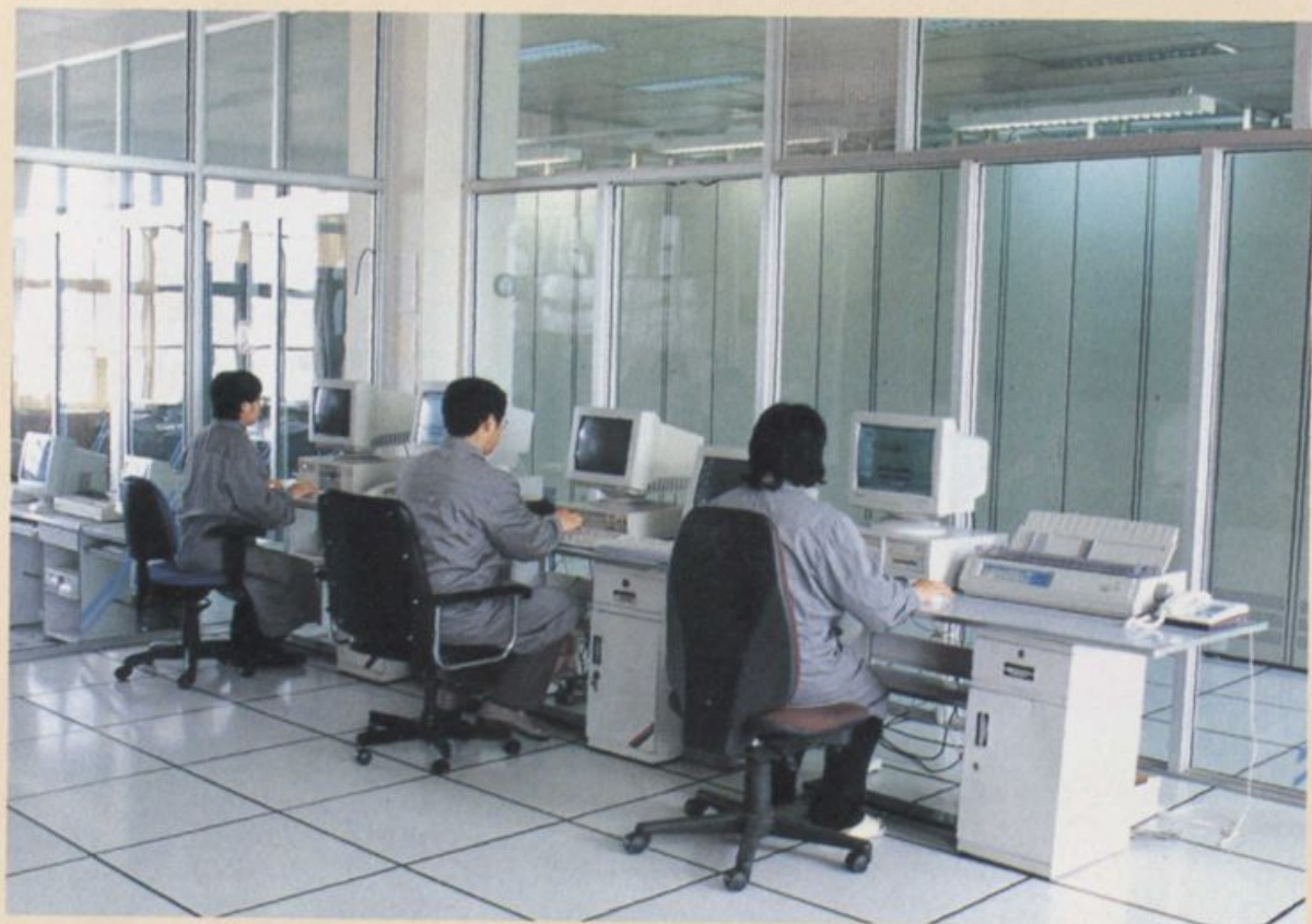
电信程控电话机房
