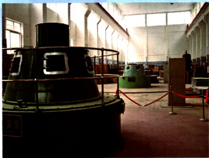
水电十局承建的姜射坝水电站发电机组厂房
