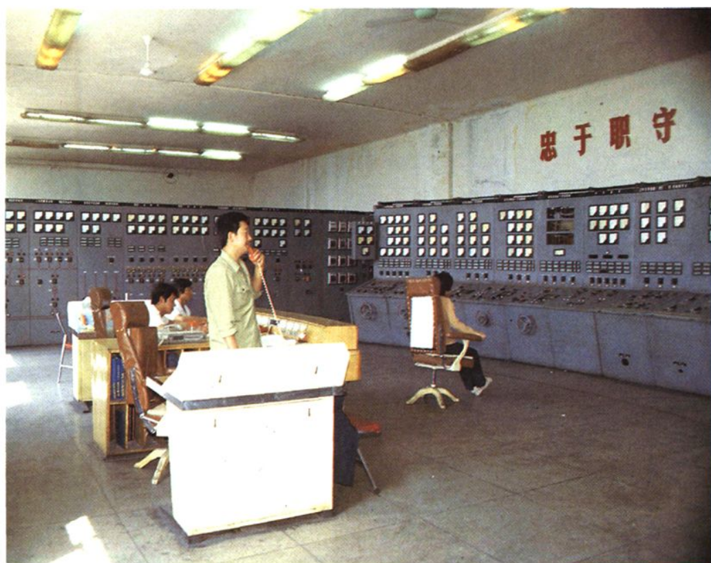
大同一电厂主控室
