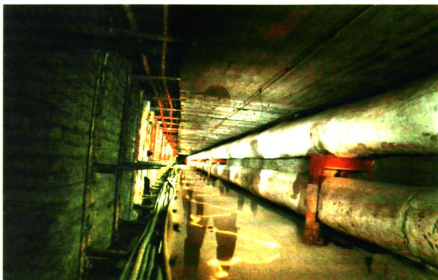
综合管道(1958 年建)
