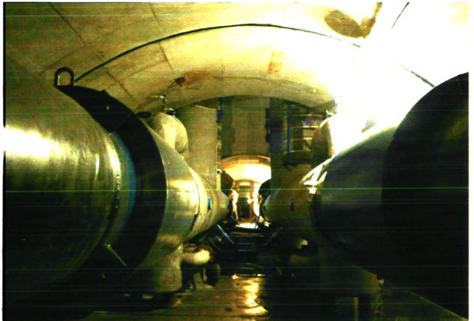
通行地下管线 (1998年建)
