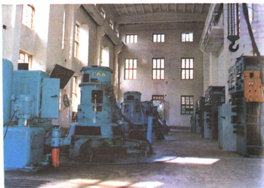
陡山水电站发电机组
