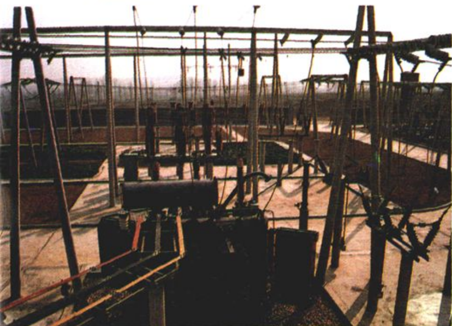
二〇千伏坪上变电站主变
