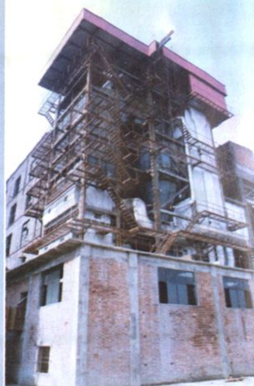
75T/H 循环流化床锅炉
