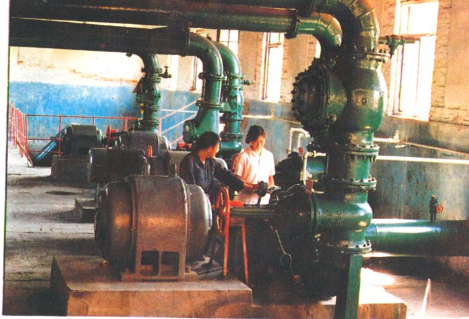
→ 动力水泵主泵房
