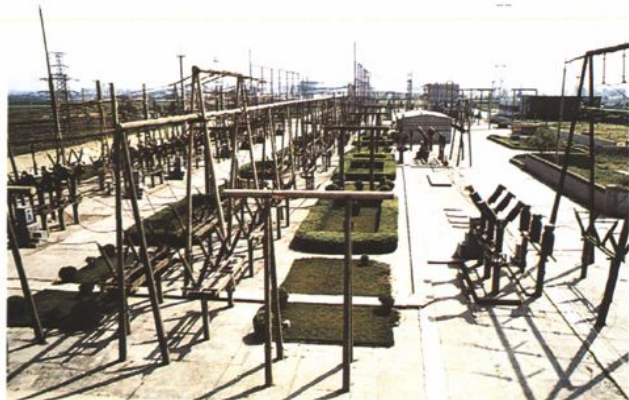
山东省第一座 220 千伏变电站——魏家庄变电站
