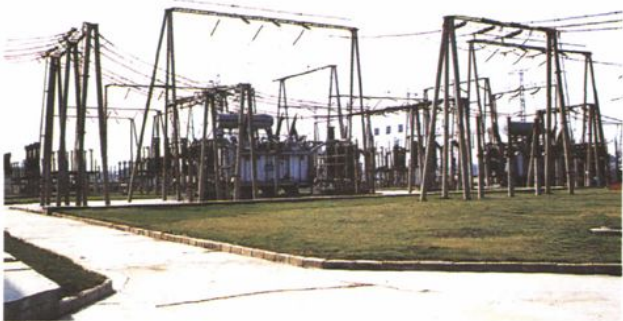
220 千伏博山变电站
