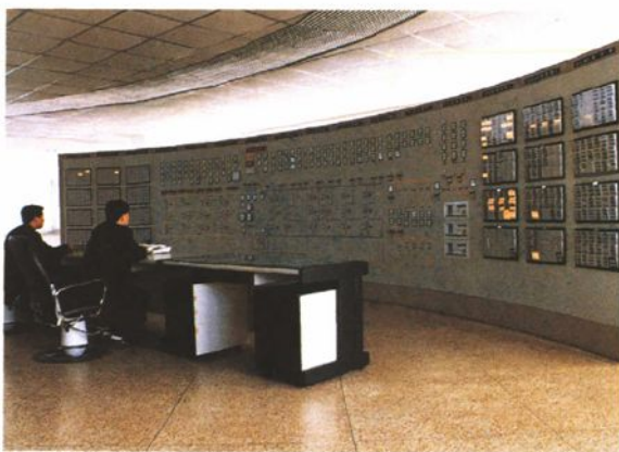
500 千伏淄博变电站控制室
