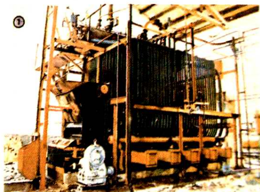
太原锅炉厂生产的双筒无烟煤链条炉荣获国家节能奖。
