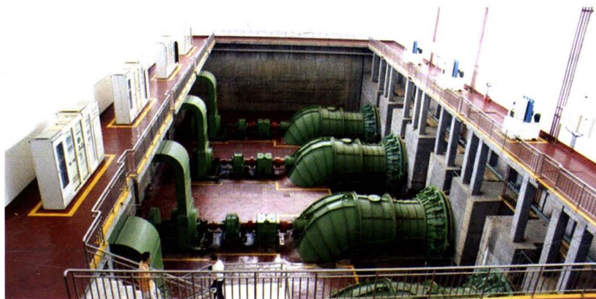
朗江电站机房
