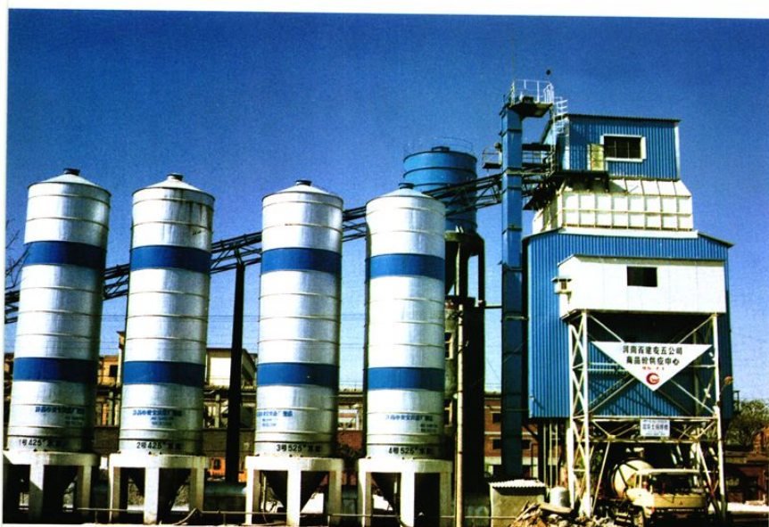
大型商品砼供应中心
