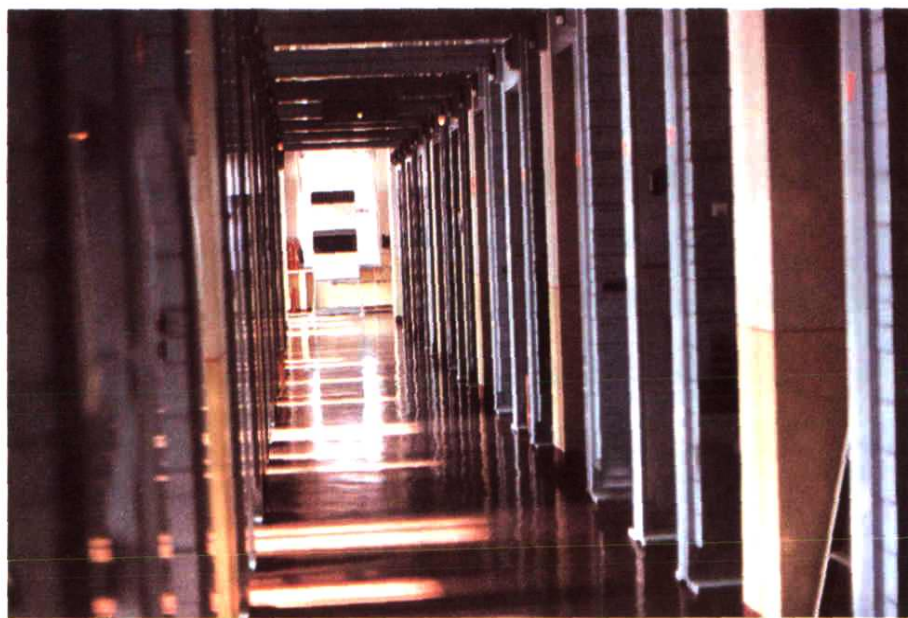
纵横制交换机机房
