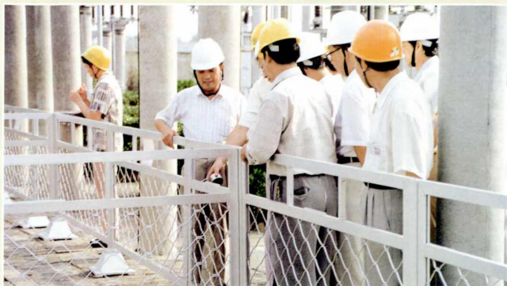
局领导及 有关科室人员 在江都检查变 电所安全遮栏
