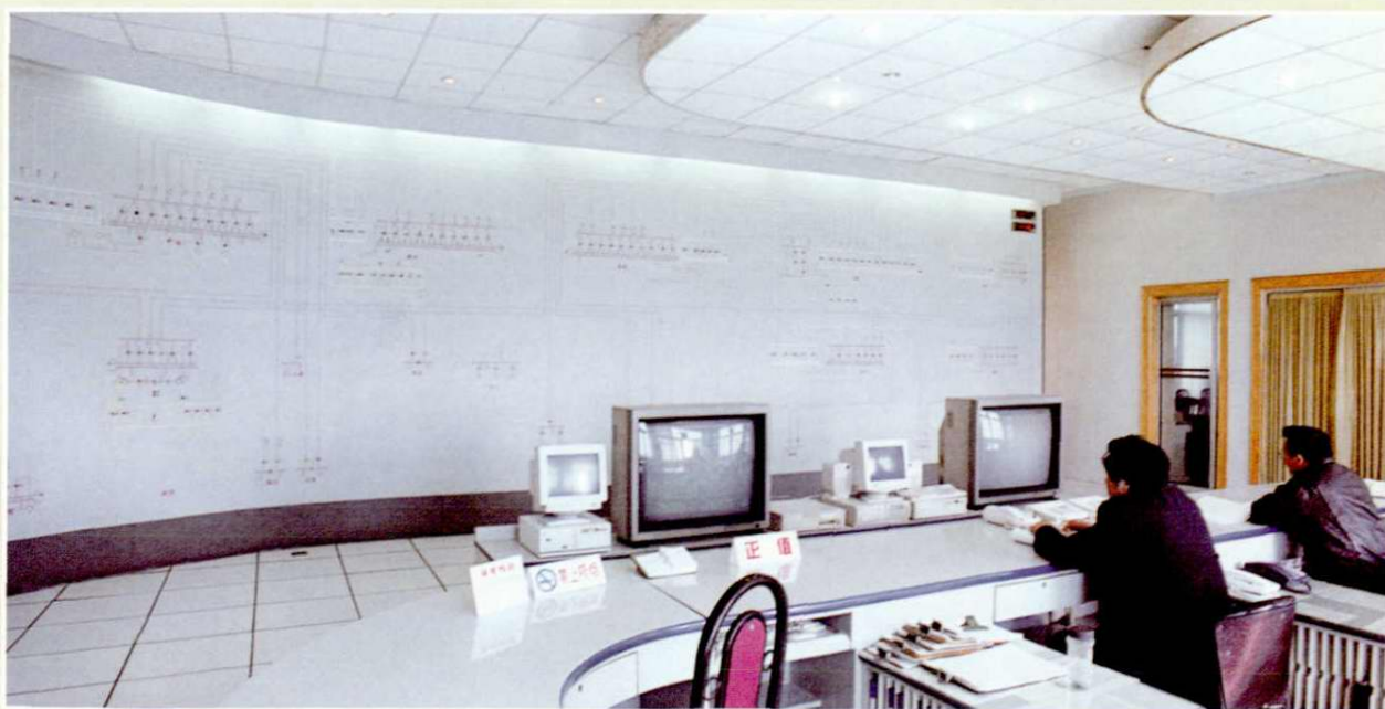
扬州供电局电网调度中心
