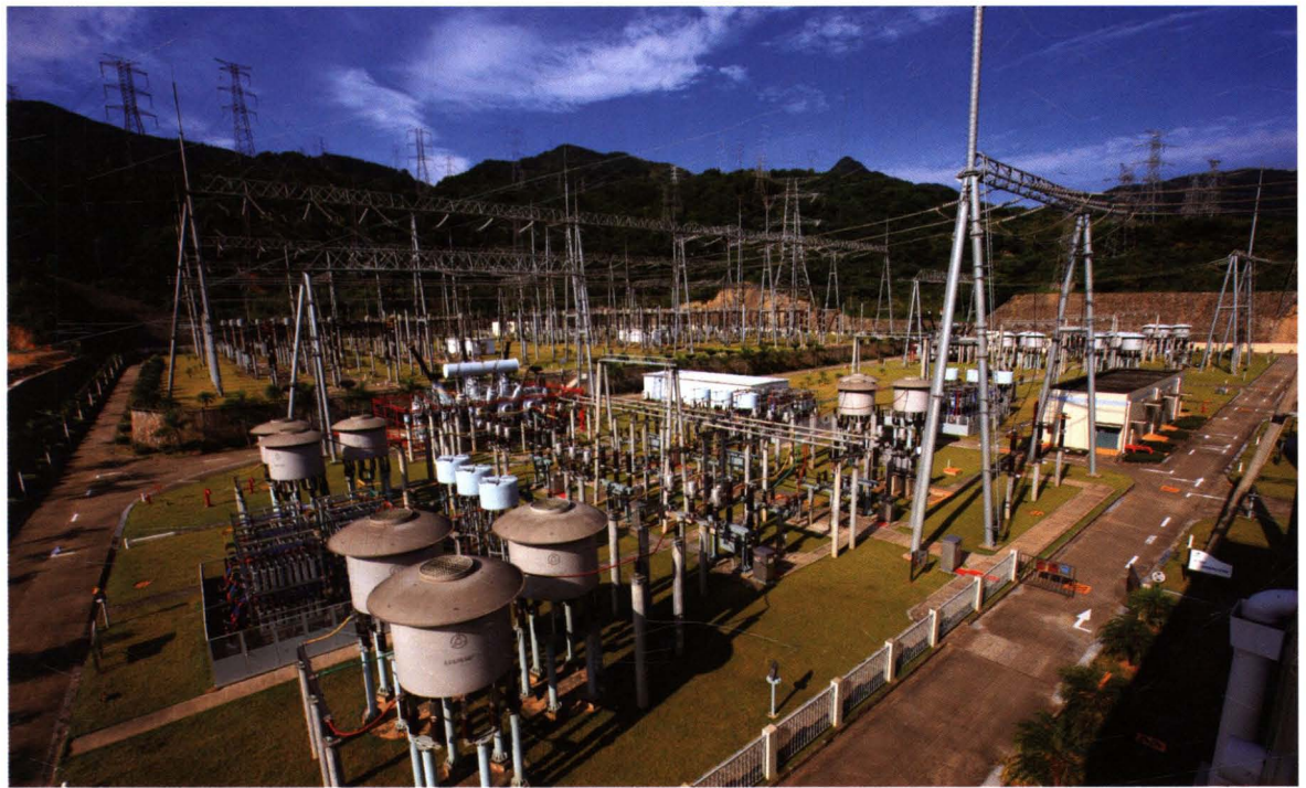
福建与华东联网的枢纽变电站——500千伏福州变电站，主变压器2台，总容量150万千伏·安，于2001年11月3日投运
