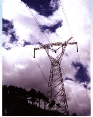
第一条与华东联网的线路工程，500千伏福州—金华双龙第一回线路全长164.65千米，于2001年11月投运
